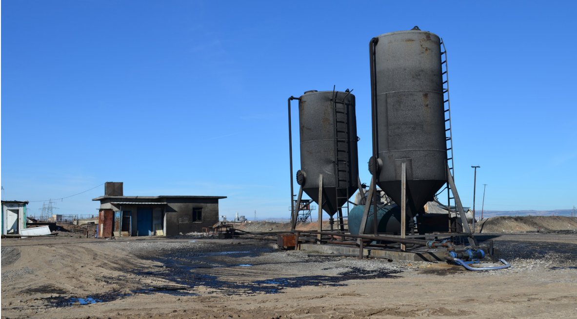
مخزن النفط ومكتب رجال الإطفاء في منطقة تصفية محطة السويدية للغاز والكهرباء
