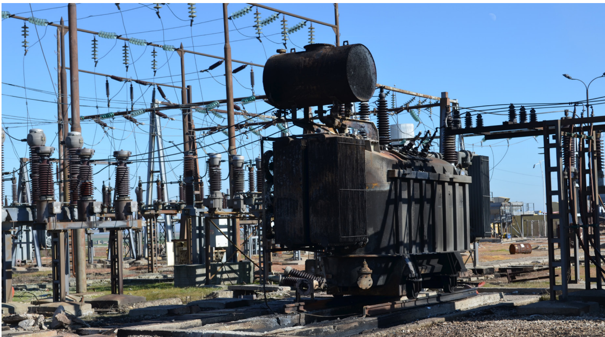
محولات في محطة السويدية للغاز والكهرباء
