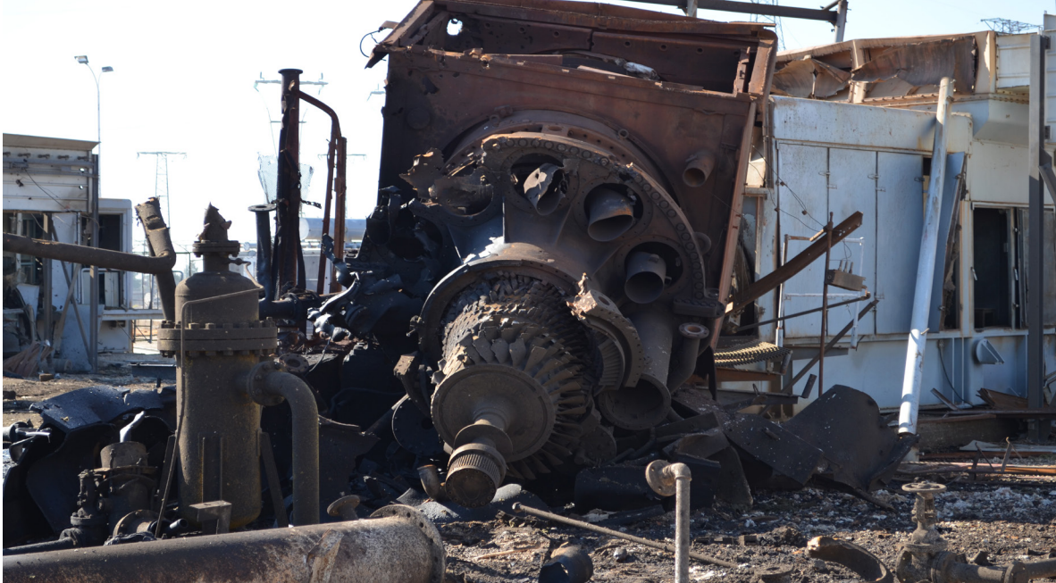
عنفات محطة السويدية للغاز والكهرباء
