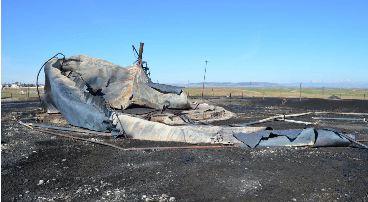
المخزن الرئيسي لتصفية النفط في محطة السويدية للغاز والكهرباء
