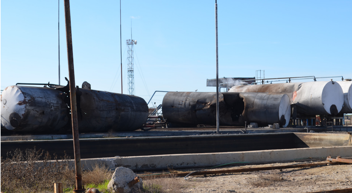
مستودعات الوقود في محطة السويدية للغاز والكهرباء
