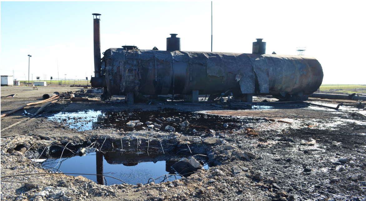
مصافي النفط في محطة السويدية للغاز والكهرباء
