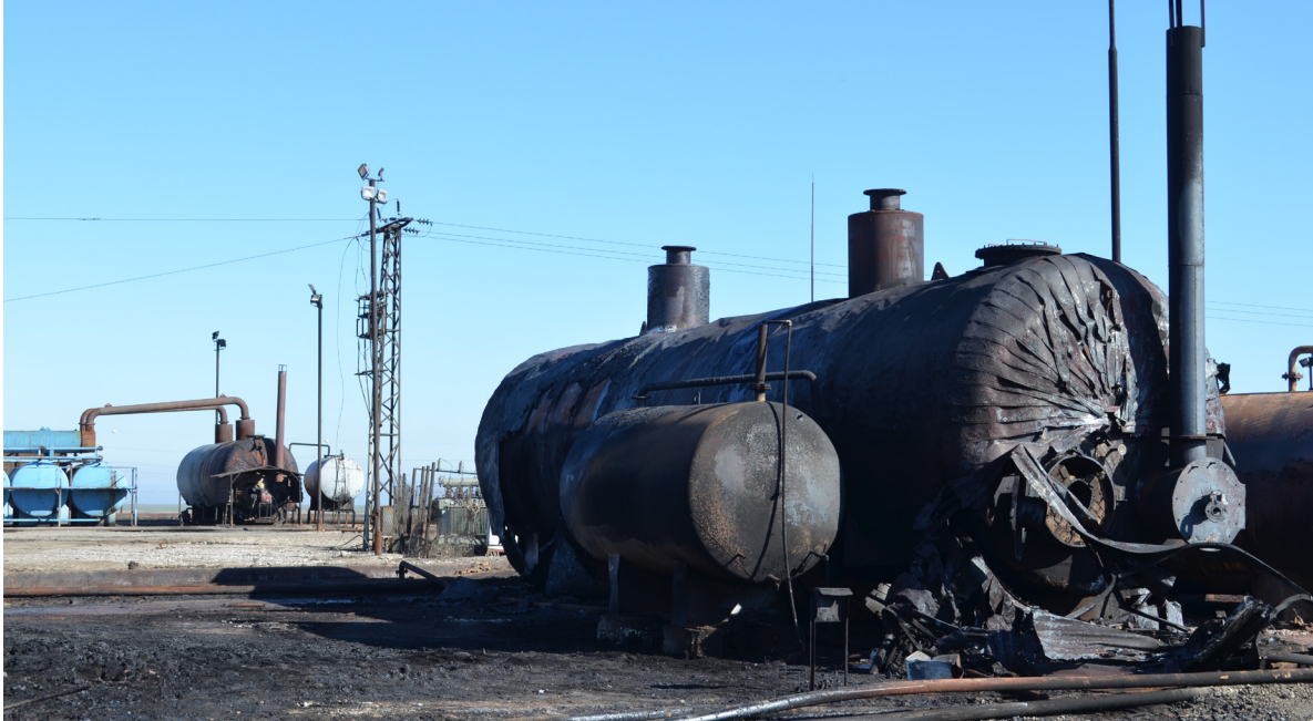
مصافي النفط في محطة السويدية للغاز والكهرباء
