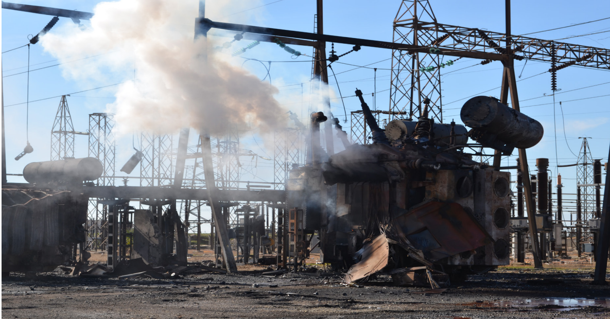
محولات في محطة السويدية للغاز والكهرباء
