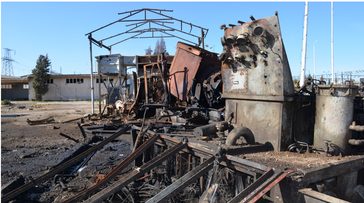
عنفات محطة السويدية للغاز والكهرباء
