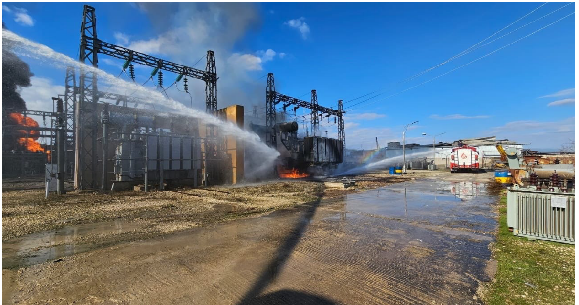
محطة كهرباء كوباني بعد الغارة الجوية التركية، 14.01.2024
