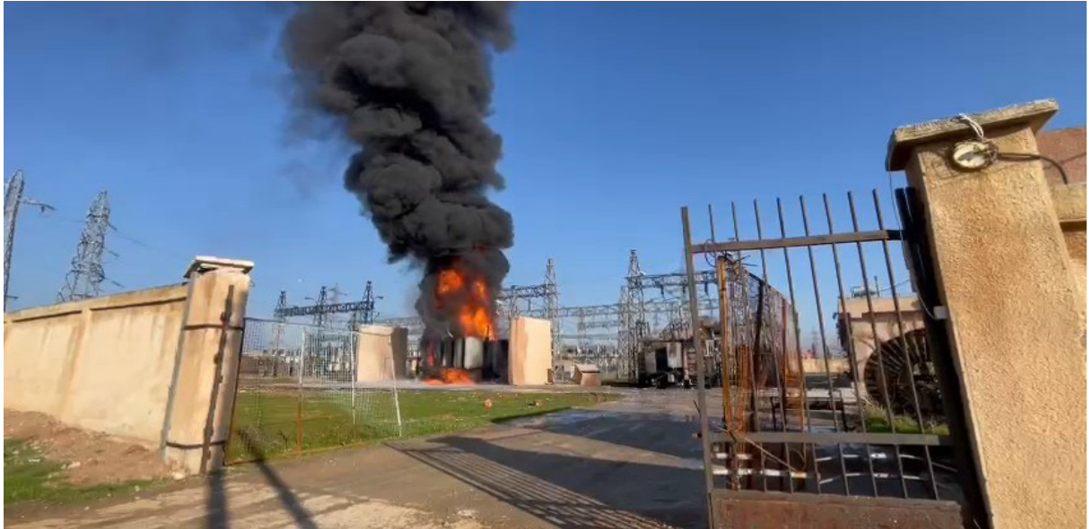
محطة كهرباء قامشلو إثر الغارة الجوية التركية، 15.01.2024
