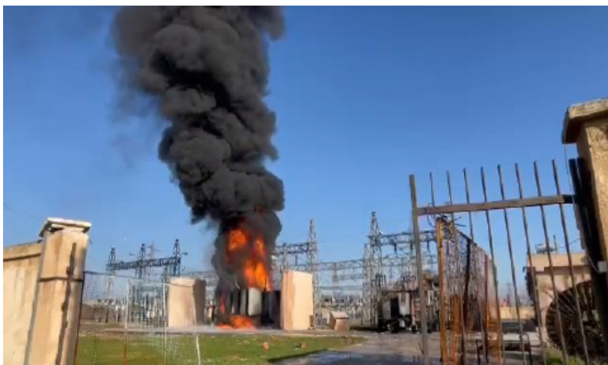
La stazione elettrica di Qamishlo dopo gli attacchi aerei turchi, 15.01.2024
