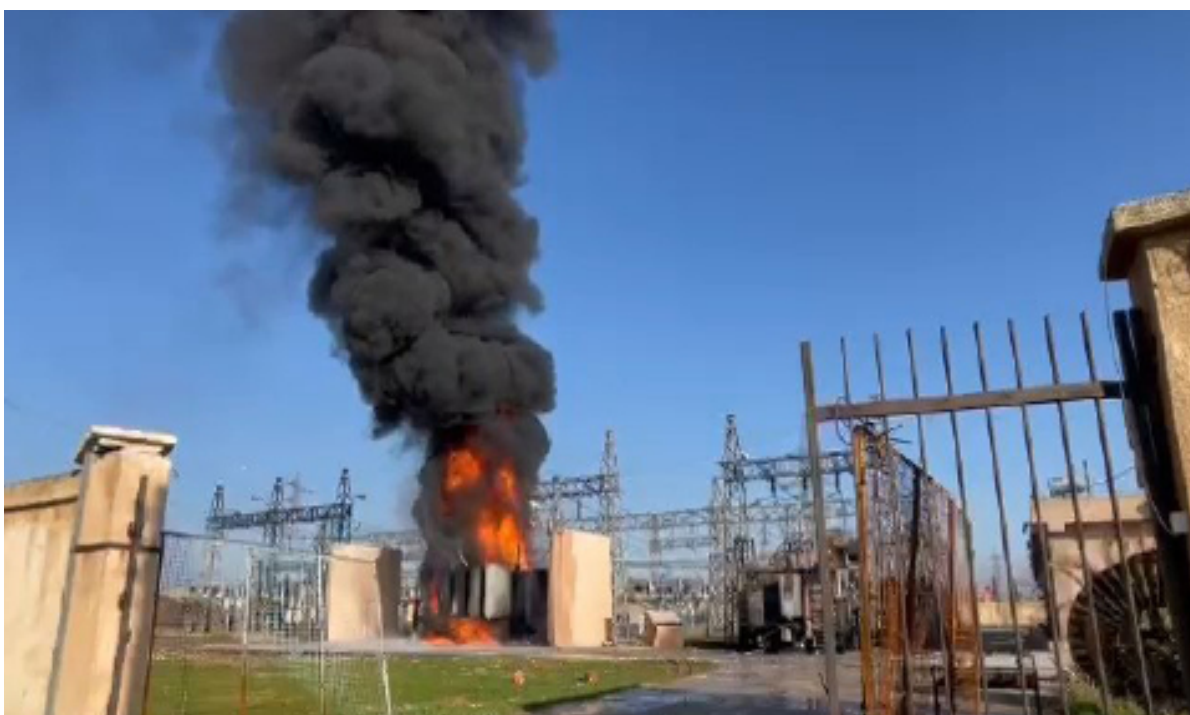
Elektrizitätswerk in Qamishlo nach türkischem Luftangriff, 15.01.2024
